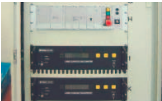
Bild 2: Röntgensteuergeräte (oben) und LSV-Controller (unten) in einem Schaltschrank kombiniert
